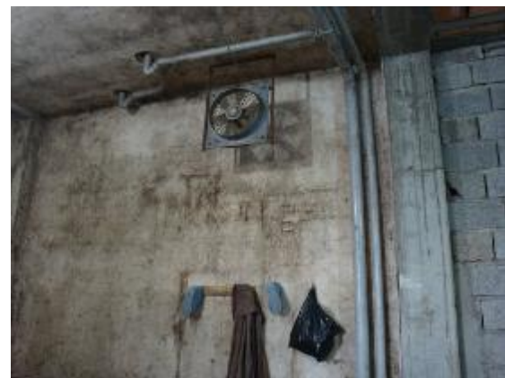
شکل ۱۰ - نصب فن در مکان نامناسب
